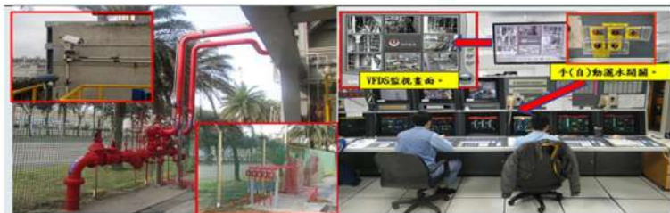
↑廠區消防設備整合
